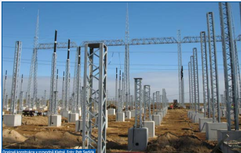
Ocelové konstrukce v rozvodně Kletné. Foto: Petr Sedlák
