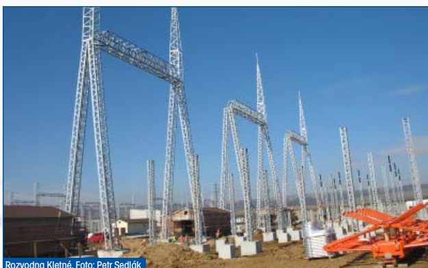
Rozvodna Kletné. Foto: Petr Sedlák
