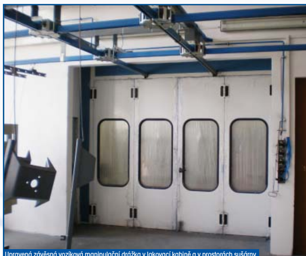
Upravená závěsná vozíková manipulační drážka v lakovací kabině a v prostorách sušárny
