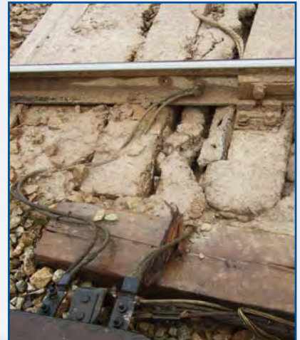
Sovětská zabezpečovací technika spolehlivě pracuje i v takovýchto podmínkách – stykové transformátory vjezdového nádvěstí žst. Klooga. Foto: T. Krčma
