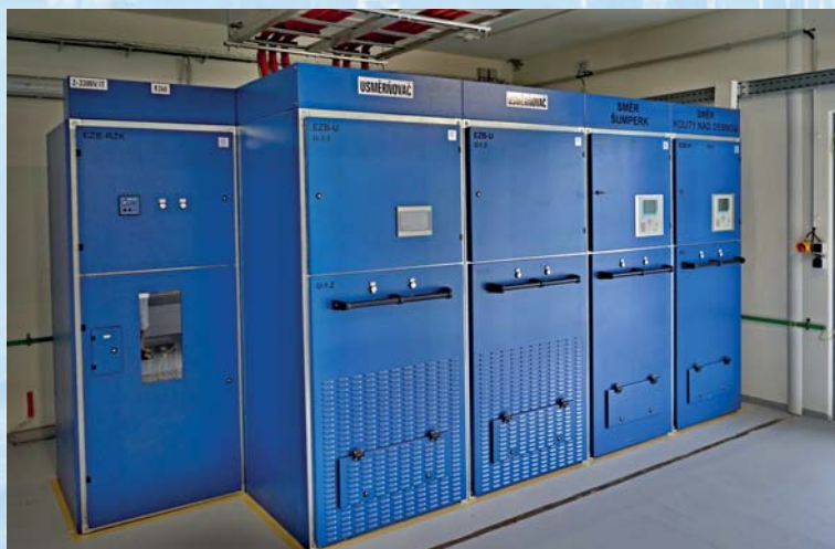
Sestava rozváděče R3 kV s usměrňovačem v TM Filipová
